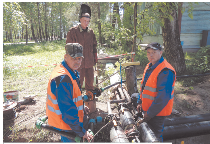
Бригада Александра Александровича Булатова производит монтаж теплоузла. Сварщик Алексей Новоселов, слесарь Василий Резанов
