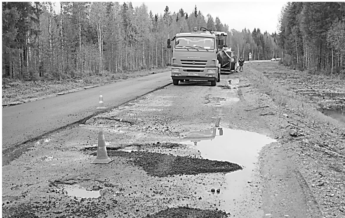
Так работали горе-строители 1 сентября 2016 г.
